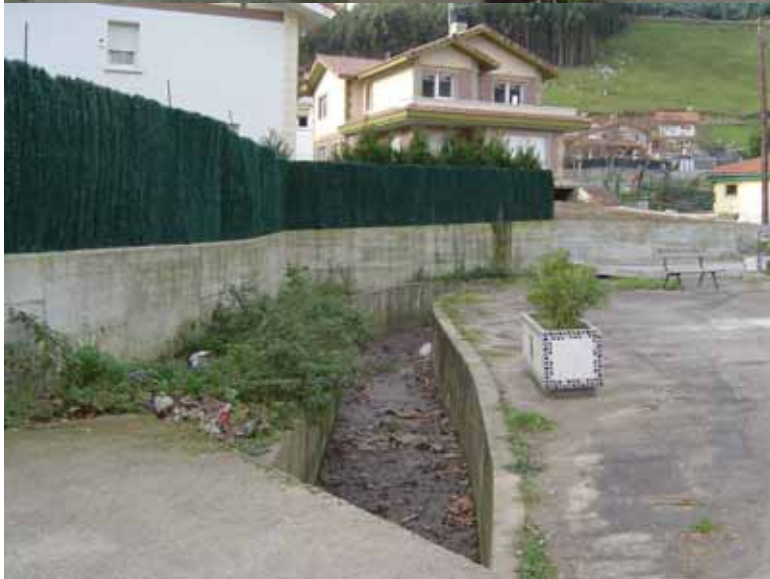
ESTADO DE ASFALTADO DE LA CALLE OKILLO:
